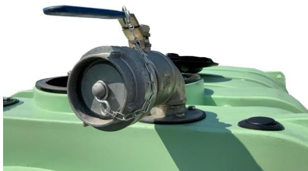
Rys. 12. Zawór kulowy przewodu tłocznego z pompy zanurzeniowej - widok zaworu w pozycji otwartej
